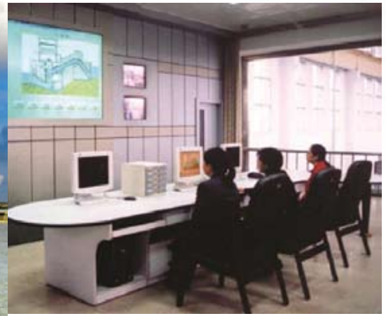
• 中控室 Central control room
