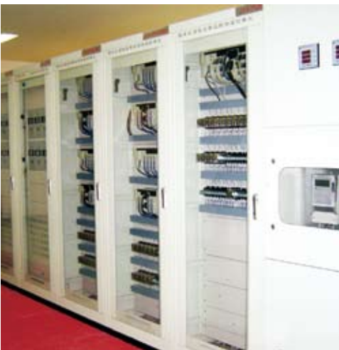
• 现地监控单元 In situ monitoring unit
